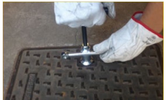
Fase 1: fijación de la barra central en la posición favorable a la palanca.
